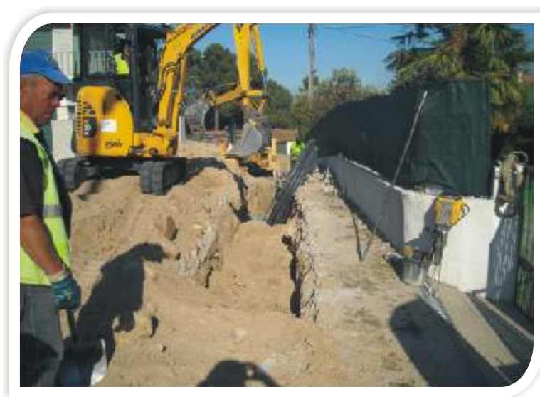
FOTO 4 - Rede de drenagem de esgotos das aldeias de Mondrões e Bisalhães
